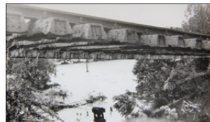
Zerstörte Bahnbrücke unterhalb Tüppeln, ehemalige Höhe des Gleises über Gelände: 15 Meter (Aufnahme vom 10.08.1981, 15 Uhr)
